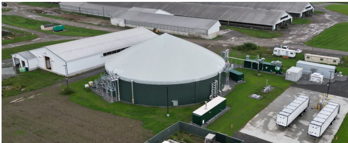
Die Biogas- und Gasaufbereitungsanlagen Oakridge Dairy Biogas Plant (1) und Curtin Dairy (2) sind bereits seit 2023 am Netz.
