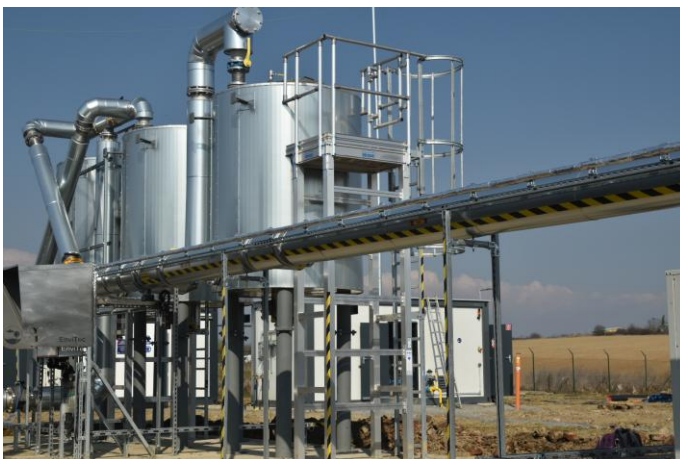
Dank dieser Anlage werden 750 Nm 3 /h Biogas zu Biomethan aufbereitet. Zukünftig sollen bis zu 1.300 Nm 3 /h verarbeitet werden. (Foto EnviTec Biogas AG)
