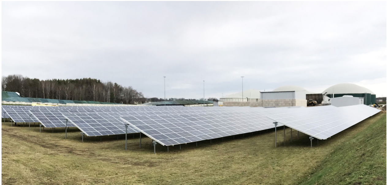
Die PV-Anlage in Forst produziert Solarstrom für den Eigenbedarf der Biogasanlage.
